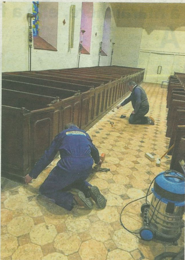
Les pièces défectueuses sous les banquettes sont remplacées par des pièces en plastique.
