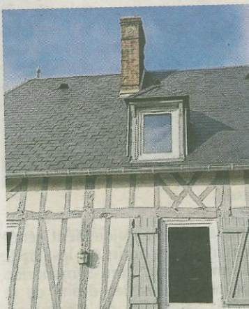
La réfection de la couverture faisait partie des travaux indispensables (Photo PN)
